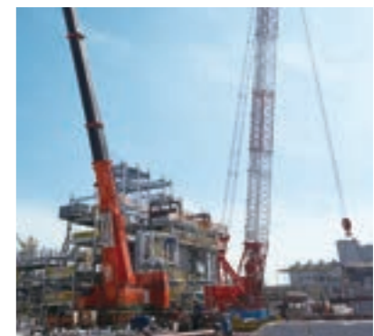
新規ガスタービンコージェネレーションの設置工事の様子
