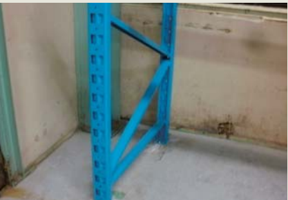
一部ラックのアンカーボルトがなく転倒防止措置も不十分だったため、全数確認した上でラックを更新し、アンカーボルトで固定しました
