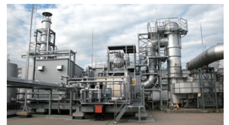
脱臭炉排熱回収蒸気ボイラー
