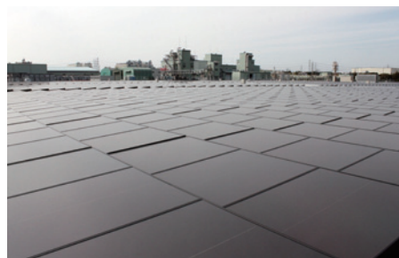
鹿島工場西地区の太陽光発電システム
