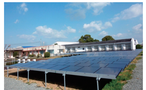
九州カネライト株式会社では地上と建屋の屋根に設置
