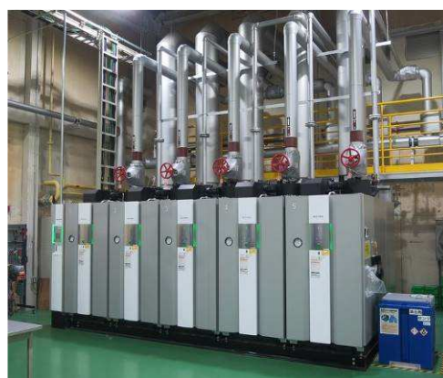
貫流ボイラー
